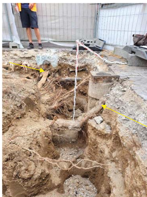
Abbildung: Wurzeleinwuchs in Leitungstrassen
