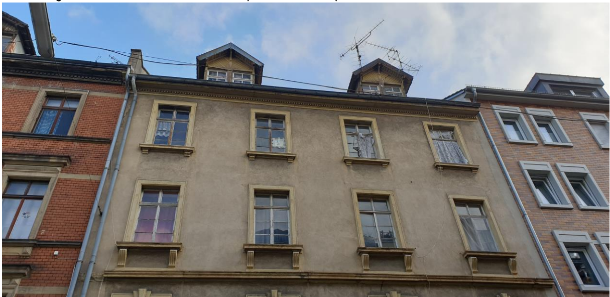
Abbildung 17: Stark schadhafte Fenster (Werderstraße)
