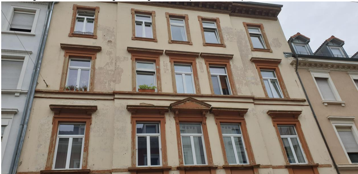
Abbildung 6: Stark erneuerungsbedürftige Fassade (Wilhelmstraße)
