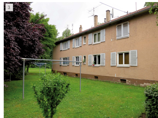
In der Volkswohnsiedlung finden sich heute, in Teilbereichen, stark defizitäre Gebäudesubstanzen.
