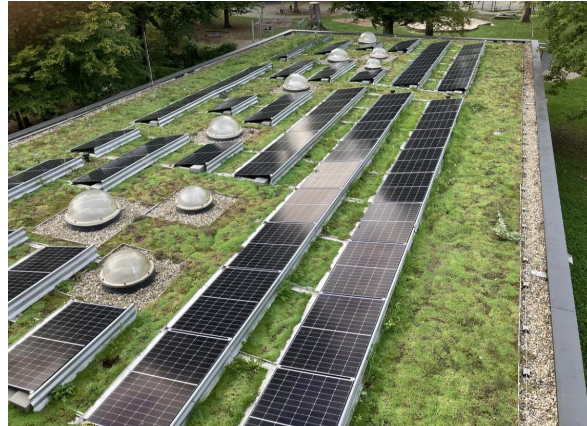
PV-Anlage auf dem Kindergarten Albschule
