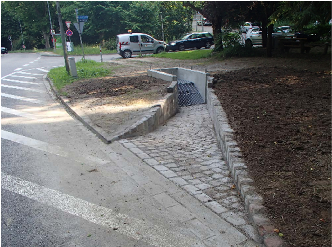
Abbildung 92: Geröllfang in der Rittnertstraße – In der Tasche. Foto: Stadt Karlsruhe Tiefbauamt.
