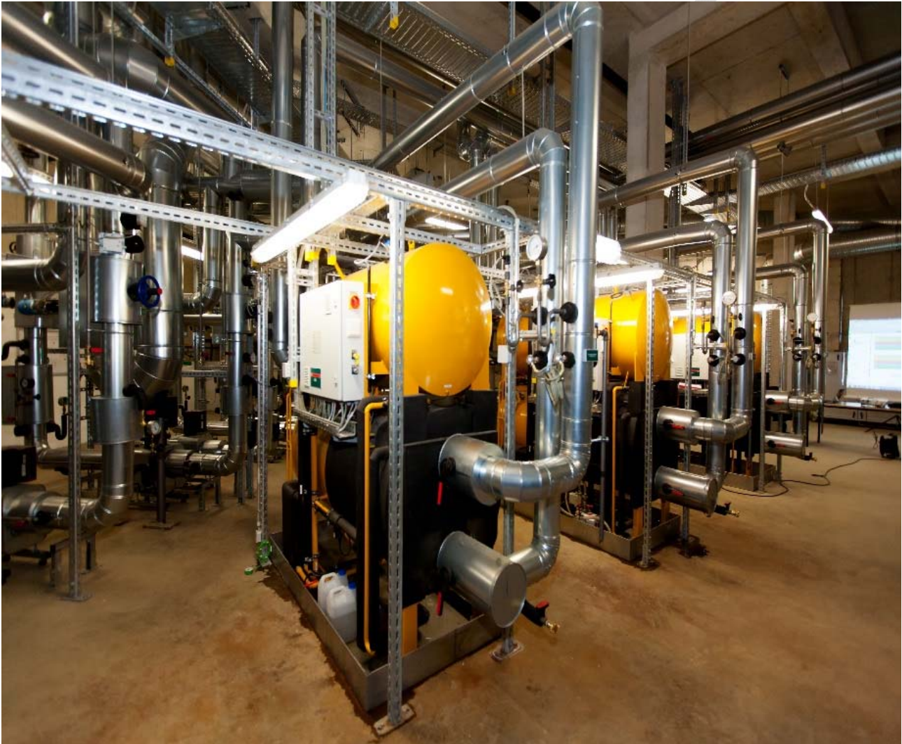
Abbildung 96: Kälteanlage. Foto: Stadtwerke Karlsruhe.
