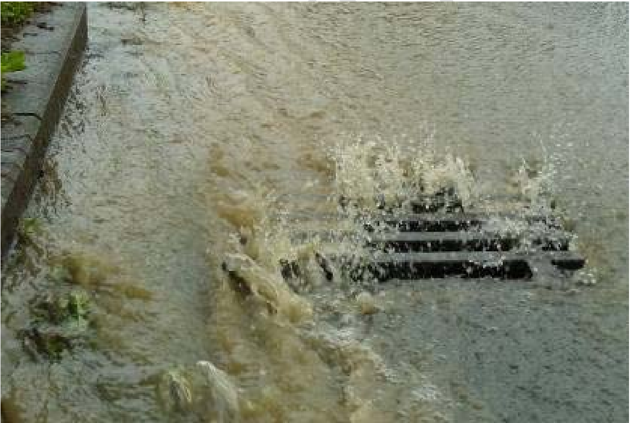
Abbildung 85: Überströmter Straßenablauf. Foto: Stadt Karlsruhe, Tiefbauamt.
