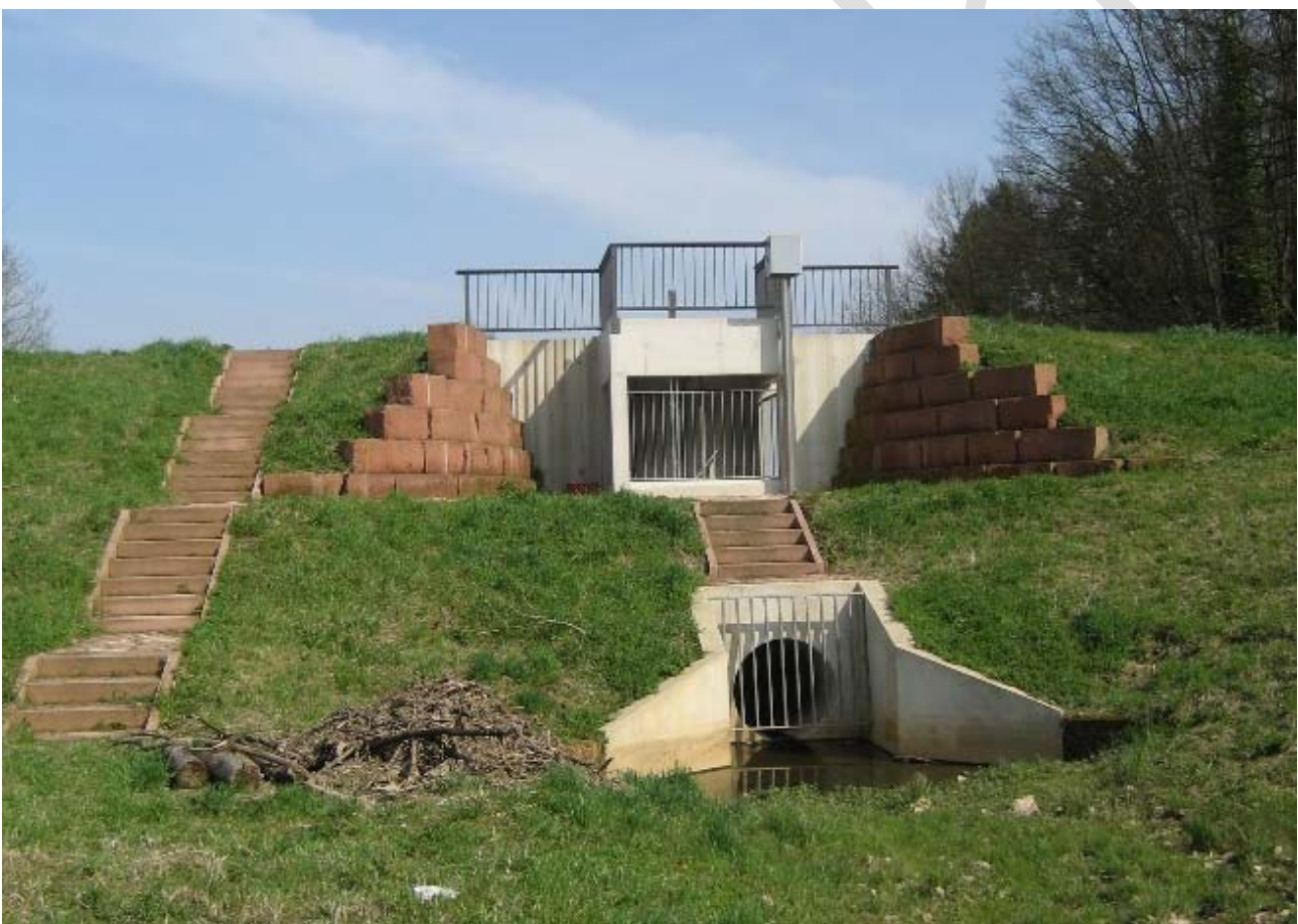
Abbildung 91: Blick auf die Doppelsteueranlage des Hochwasserrückhaltebeckens Rittnert. Foto: Stadt Karlsruhe, Tiefbauamt.
