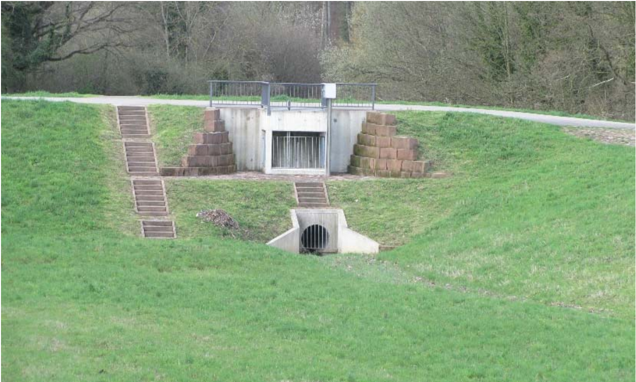
Abbildung 79: Technischer Hochwasserschutz: Hochwasserrückhaltebecken „Am Rittnert“. Foto: Stadt Karlsruhe, Umwelt- und Arbeitsschutz (Huhn).
