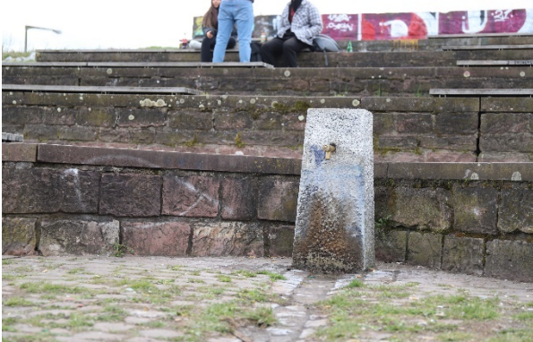
Abbildung 35: Trinkbrunnen an der Skateanlage im Otto Dullenkopf-Park, Kalkablagerungen und Vermoosung an den Oberflächen, Foto: Katrin Korth
