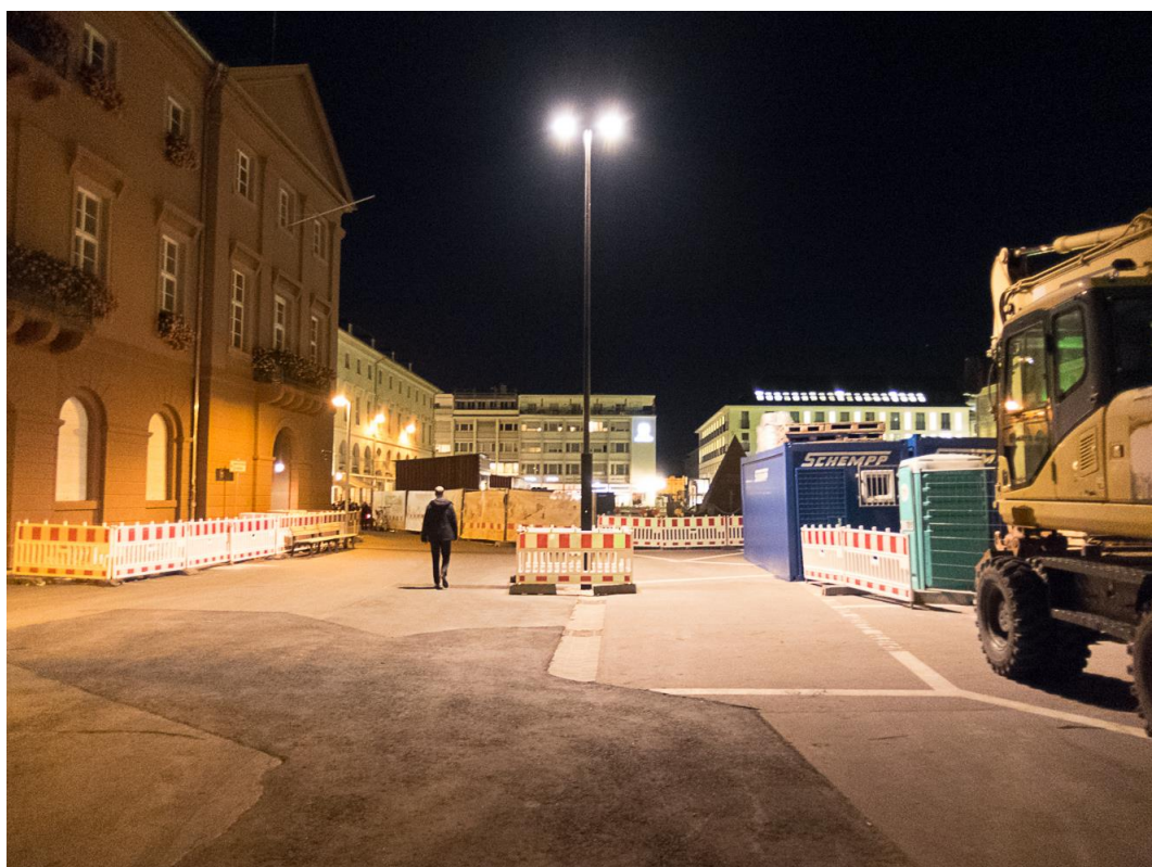
Musterleuchtstelle mit Doppelkopfleuchte vor dem Rathaus am 14.10.19
