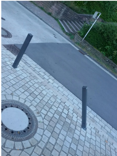
wiederkehrend umgefahrene Sperrpfosten
